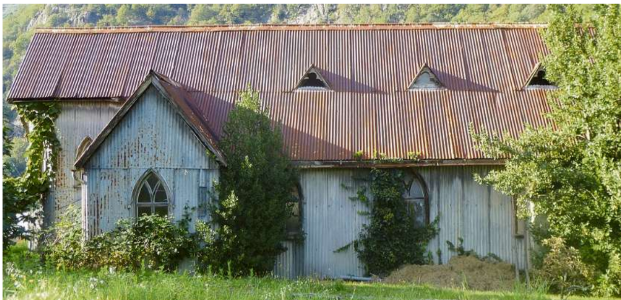
Noch ist das Dach dicht: Die ehemalige anglikanische Kirche wurde zuletzt zum Ablageplatz für Hausrat.
